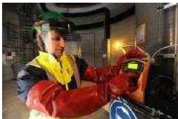
Intervention sur une pompe doseuse produit chimique
